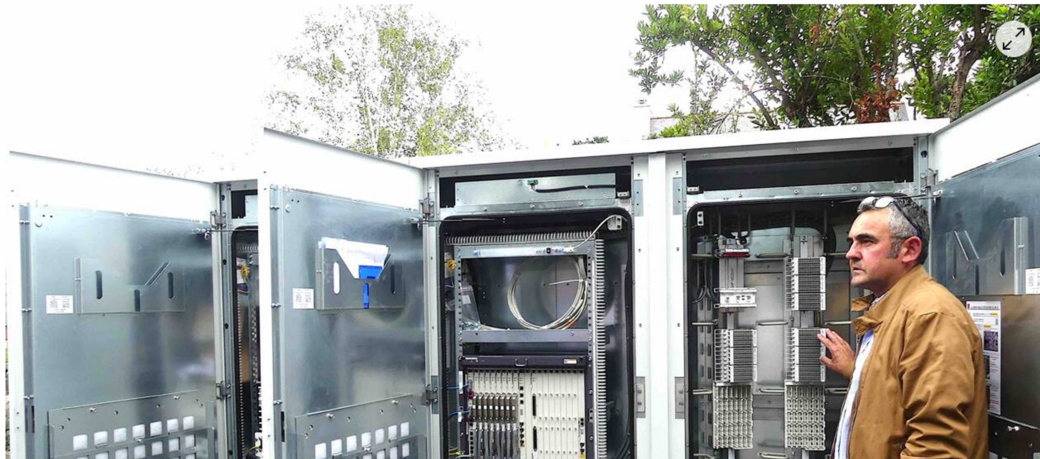
La nouvelle armoire NRA (nœud de raccordement abonnés) située sur la route de Kério. | OUEST-FRANCE
